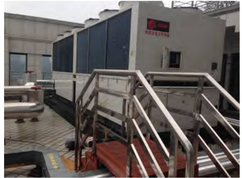
机组安装在楼顶上
