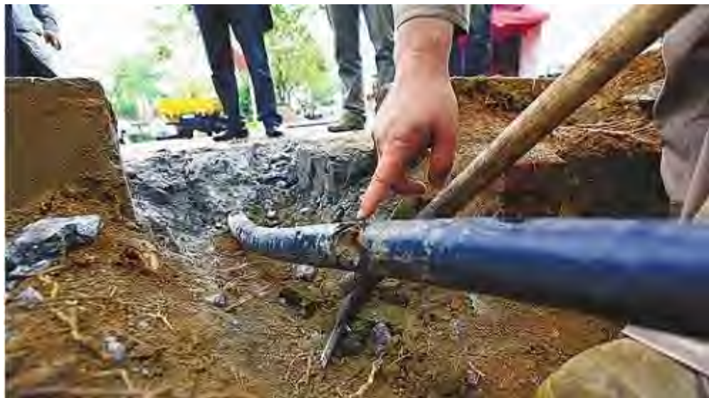
深圳 福永IDC-蛇口IDC间 线路被挖断
