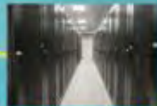
【上海松江】上海松江数据中心 8000㎡IDC, 4000机柜位
