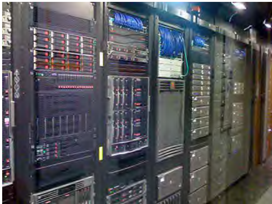
传统数据中心的构建 服务器，交换机，SAN，NAS
