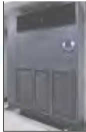
精密空调/空调机组
